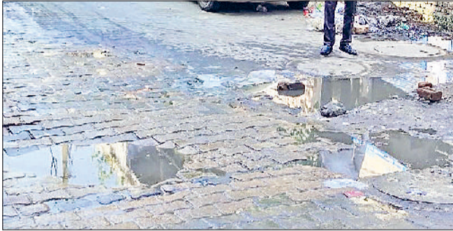
वार्ड 27 में पेयजल लाइन लीकेज होने के कारण सड़क पर जमा पानी।
